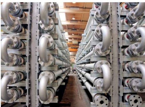
Exemple de dispositif industriel
